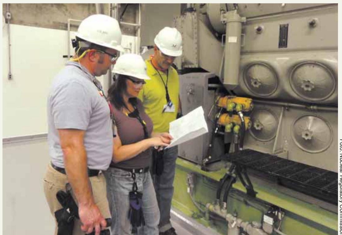
Säkerhetsinspektion av dieselgenerator för nödkraft i kärnkraftverket Kewaunee i Wisconsin.
