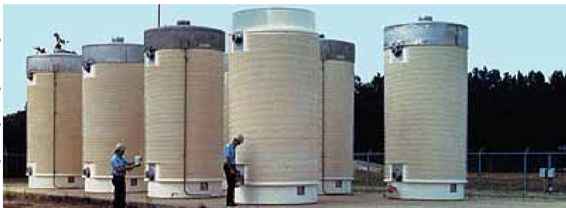
Dry Casks – luftkylda betongtorn för mellanlagring av använt kärnbränsle.
